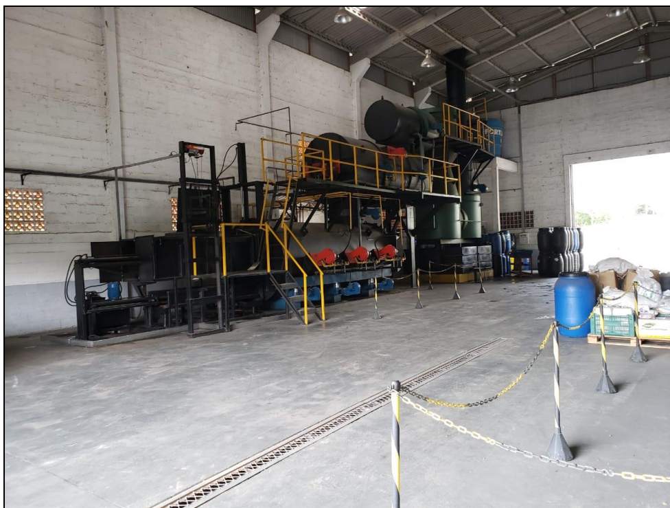
Figura 30 – Incinerador da Empresa Hera Sul Fonte: Empresa Hera Sul, 2019.
